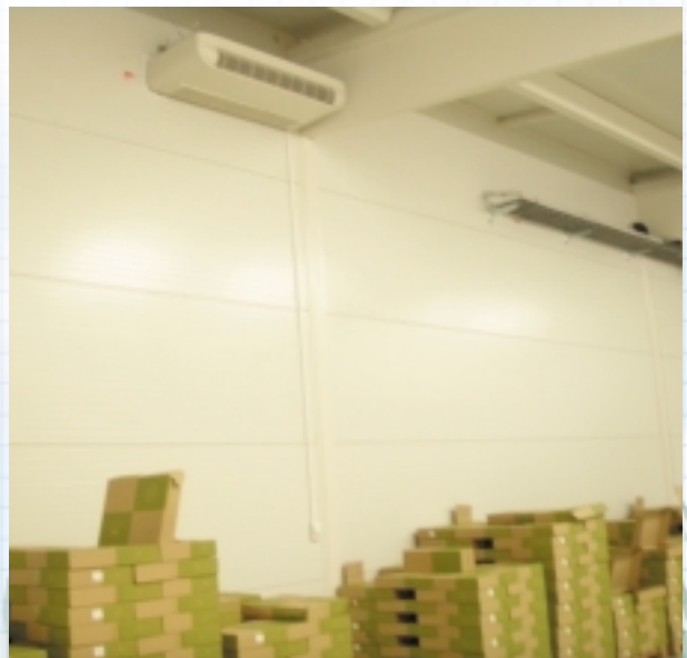
Multifunkční radiátor ve skladě vína
