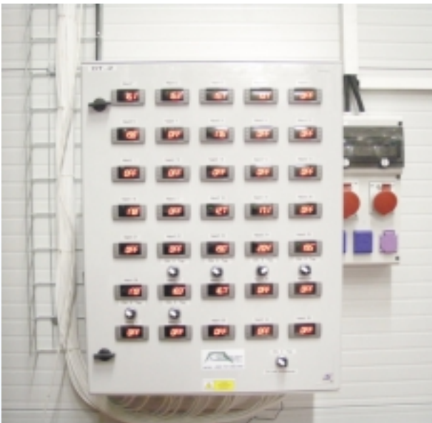
Rozvaděč řízení nádrží
