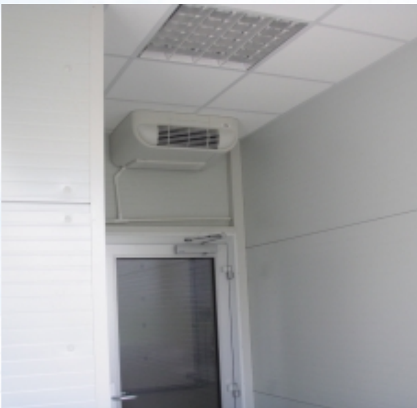
Multifunkční radiátor v kanceláři
